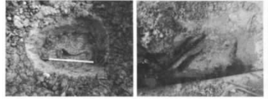
图 3 江苏省某垃圾填埋场典型的破损孔洞
